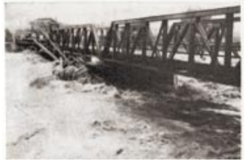
矢部川橋に体当する漂流物と激流。六月二十八日に至り橋脚傾斜し交通不能撮影時は水位は既に一、五米減水した。
